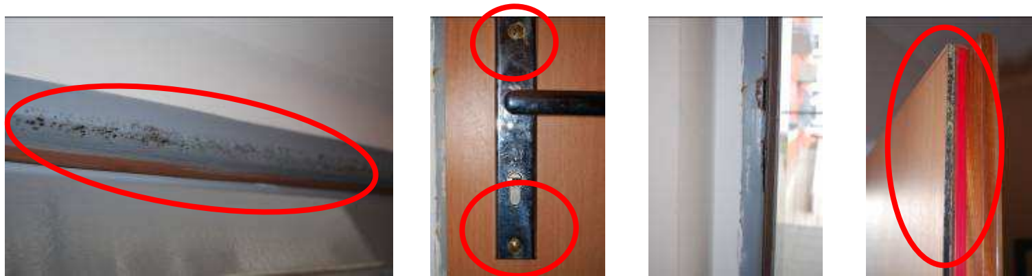
Obr. 15, 16, 17, 18 Místa napadená kondenzací vody v interiéru. Rezavé šrouby kování. Plíseň na křídle vstupních dveří.
