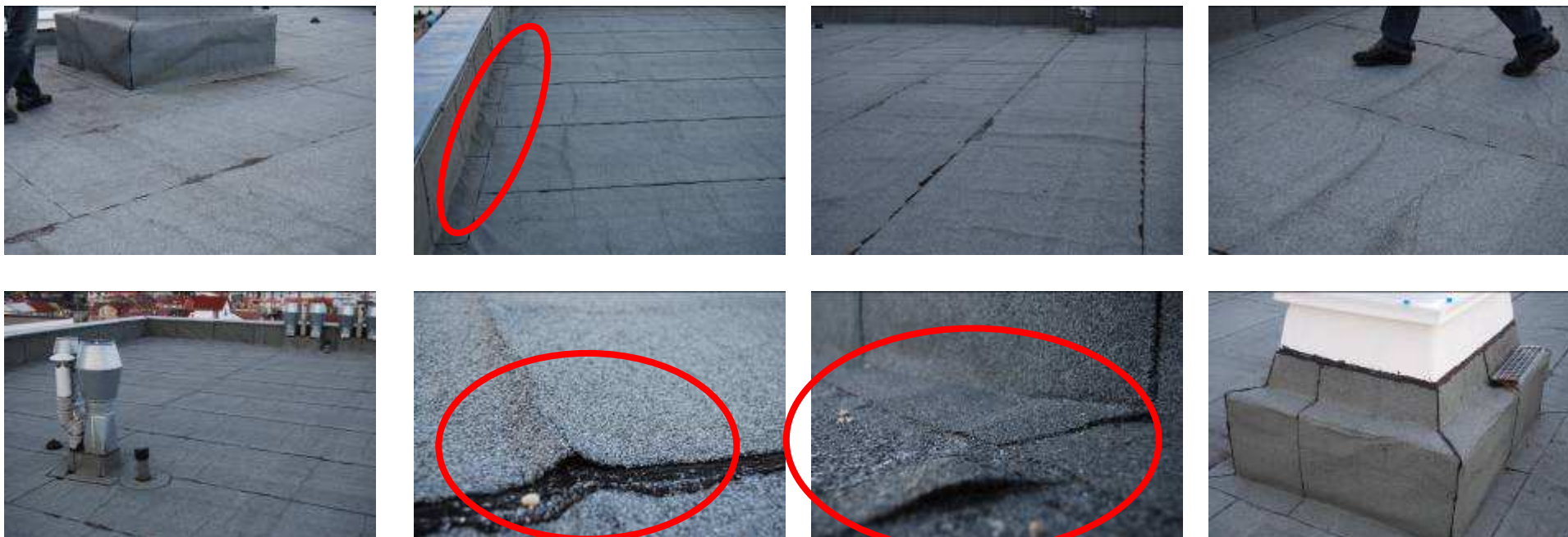
Obr. 25-32 Místa odtržené hydroizolace od podkladu. Místa nekvalitních spojů.
