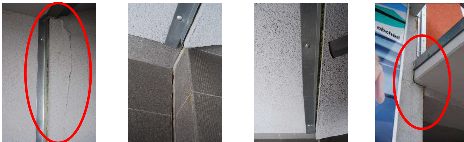
Obr. 63-66 Nepřiznaná dilatační spára - provedení následného zakrytí pomocí oplechování. Viditelné praskliny.
