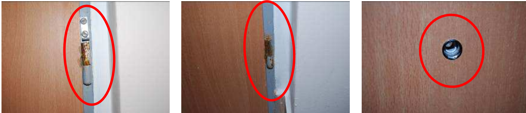
Obr. 12, 13, 14 Místa napadená kondenzací vody v interiéru - panty dveří, kukátko.
