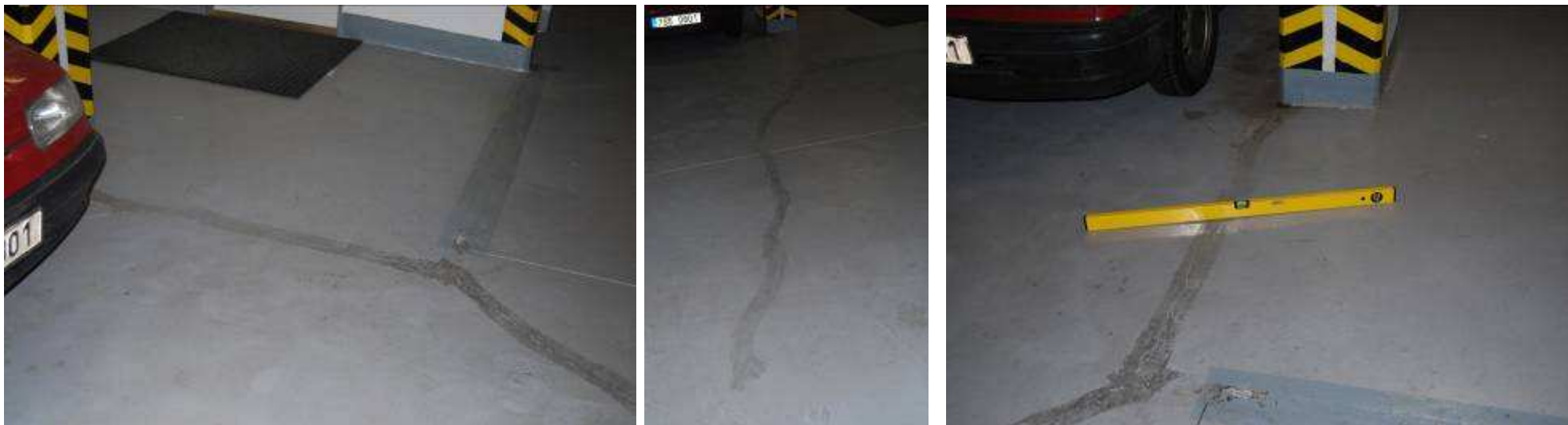
Obr. 56-58 Praskliny v betonové podlahové desce.
