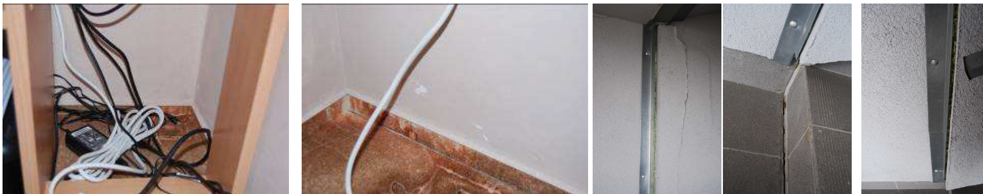
Obr. 50-51 Fotografie po opravě míst s největším výskytem kondenzace a růstu plísní v bytové jednotce. 52- 54 Dodatečně ošetřená dilatační spára v exteriéru bytové jednotky.
