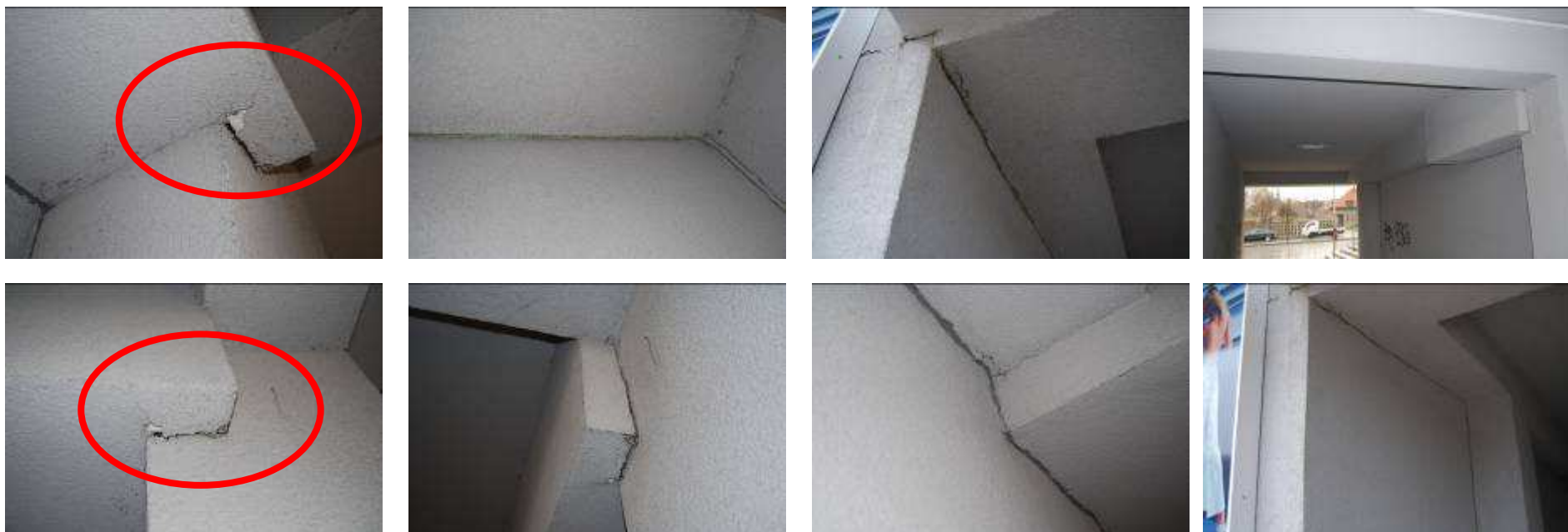
Obr. 55-62 Nepřiznaná dilatační spára. Viditelné praskliny.
